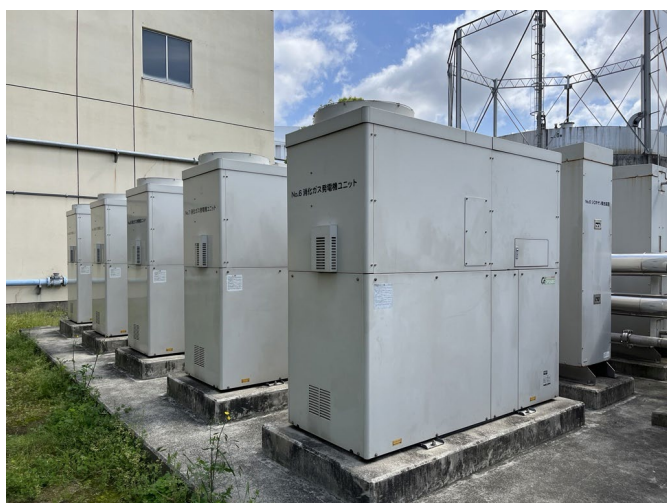
写真 バイオガス発電機
