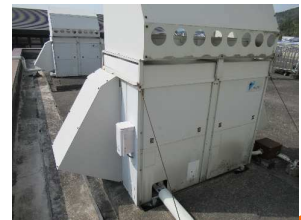
空調用省エネ制御装置の設置
